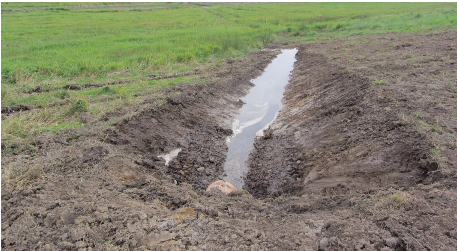
Figur 27 Eksempel på drænudløb i projektgrænsen til ny terrænnær grøft og videre udløb over terræn ved Birkemosen, Kolding.
